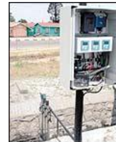
Figura 3: Sensores y transmisores de pH, turbiedad y oxígeno disuelto.
